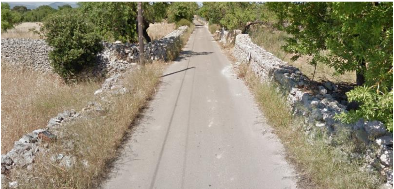
Estat dels murs de paret seca aproximadament a la meitat del tram 3. Font: google.es/maps/streetview
