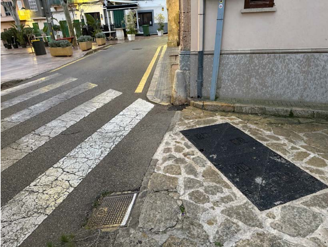
Foto 2. Arqueta Pou Església
